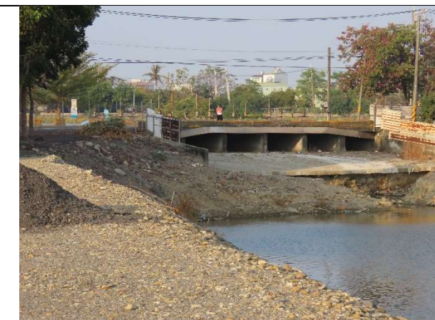
說明：溢流道下方掏空現場環境照
